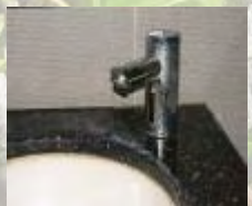
政府办公大楼洗手间使用感应自动开关水头
