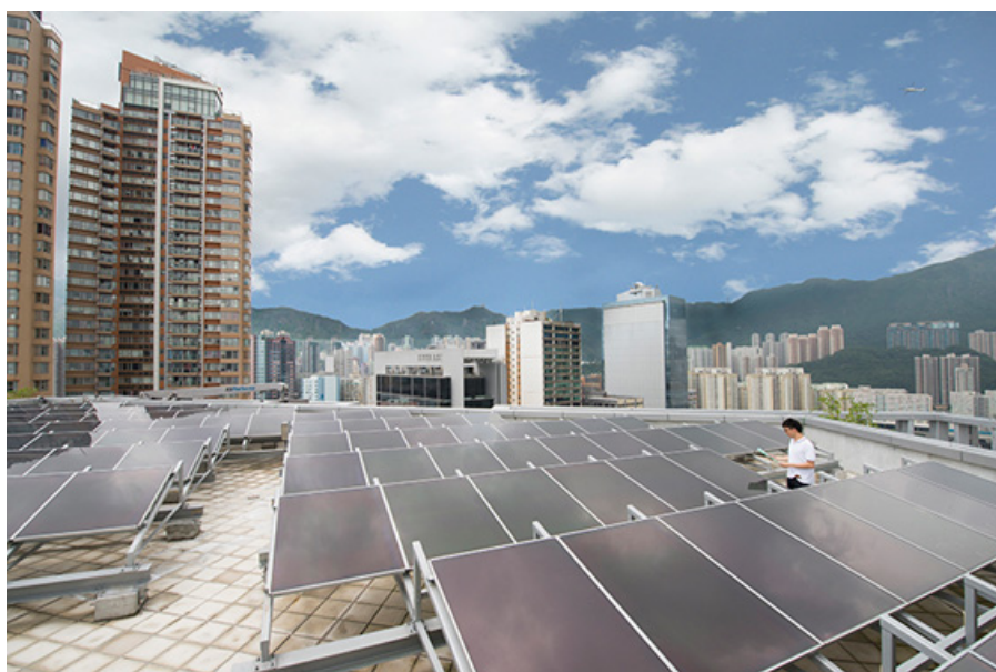
在工业贸易大楼安装的光伏板
