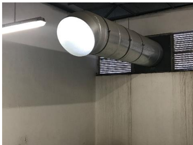
顺利纪律部队宿舍的日光管道
