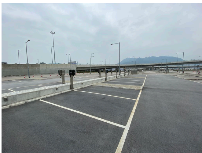
港珠澳大桥香港口岸停车场的电动车充电设施
