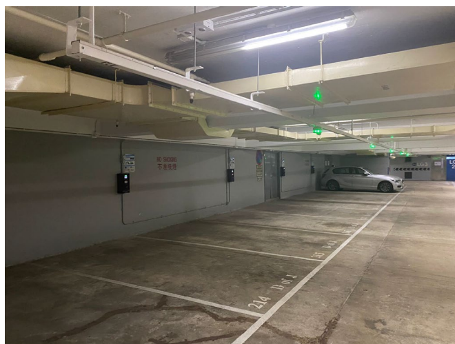
金钟道政府合署停车场的电动车充电设施
