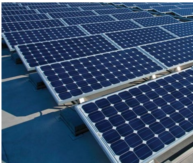
太阳能光伏板系统
