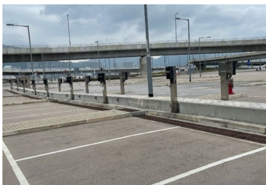
港珠澳大桥香港口岸停车场的电动车充电设施
