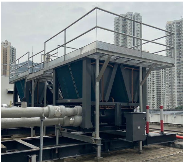
在大兴政府合署更换具备变速驱动节能器的气冷式制冷机
