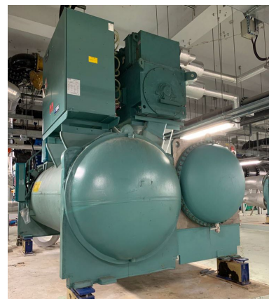
港珠澳大桥香港口岸的海水制冷机
