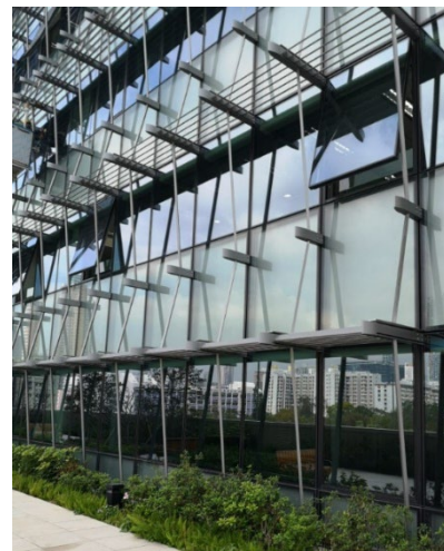
外部遮阳装置
