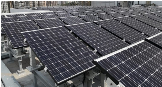
屯门政府合署的太阳能光伏板
