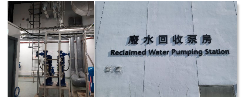
港珠澳大桥香港口岸的雨水回收系统和废水回收泵房
