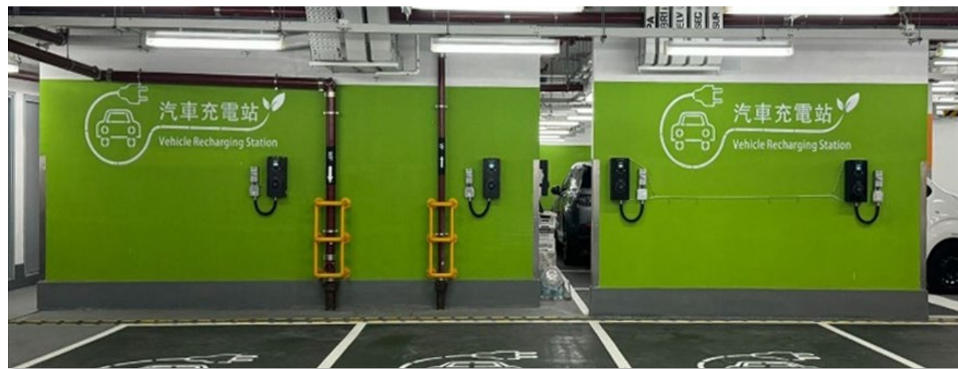
库务大楼停车场的电动车充电器
