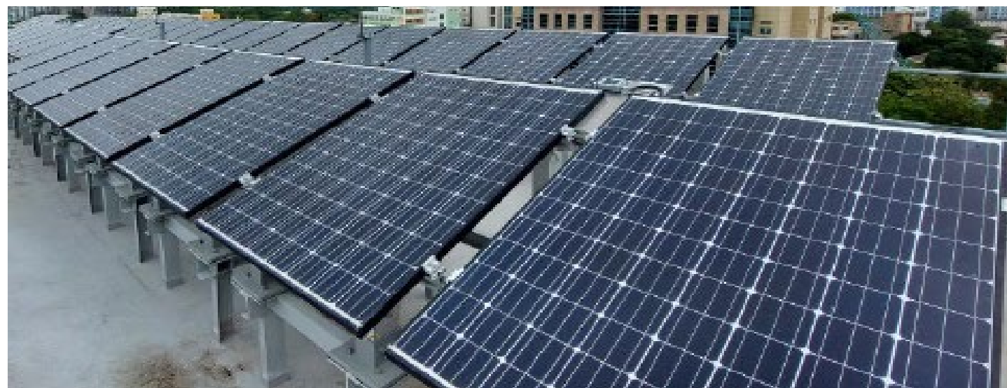
北区政府合署的太阳能光伏板系统
