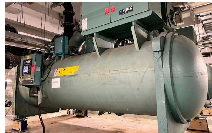
港珠澳大桥香港口岸的海水冷式制冷机
