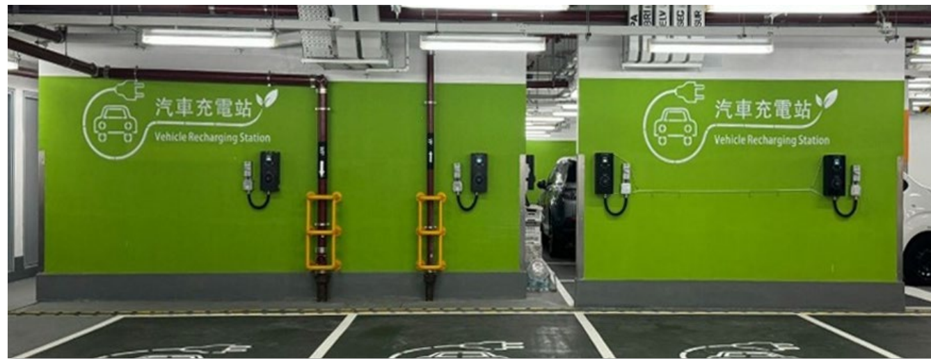
庫務大樓停車場的電動車充電器
