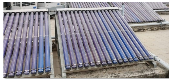
香園圍邊境管制站的太陽能熱水加熱系統
