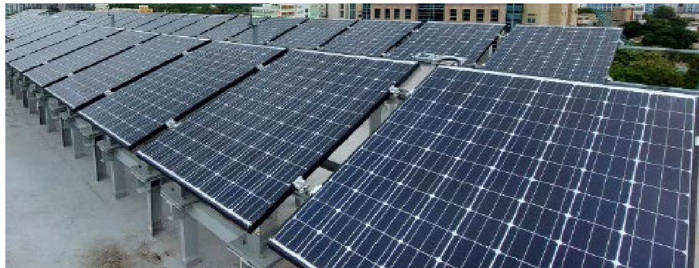
北區政府合署的太陽能光伏板系統
