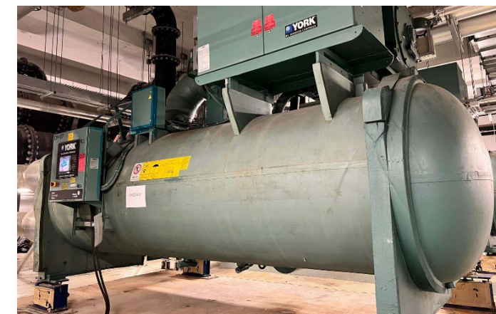
港珠澳大橋香港口岸的海水冷式製冷機
