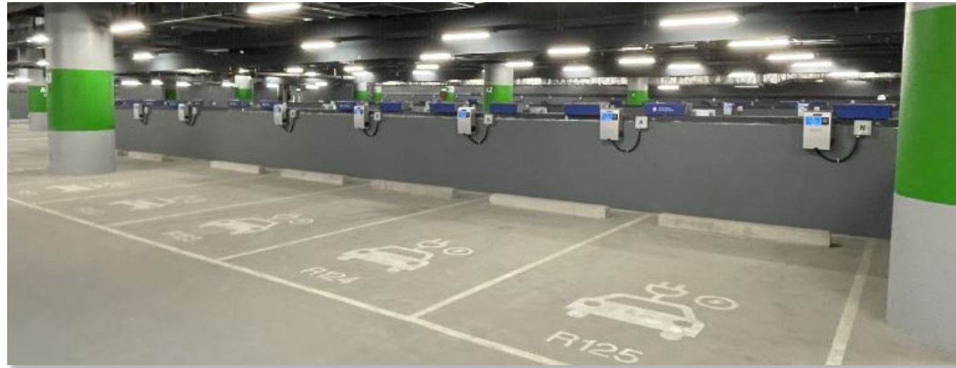
香園圍邊境管制站公眾停車場的電動車充電器
